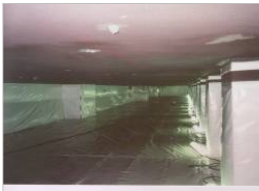
Bonifica di amianto spruzzato sulle strutture d'orizzontamento di edificio commerciale. Applicazione della tecnica del confinamento statico-dinamico mediante l'uso di piano in quota per consentire il passaggio al di sotto del cantiere.
