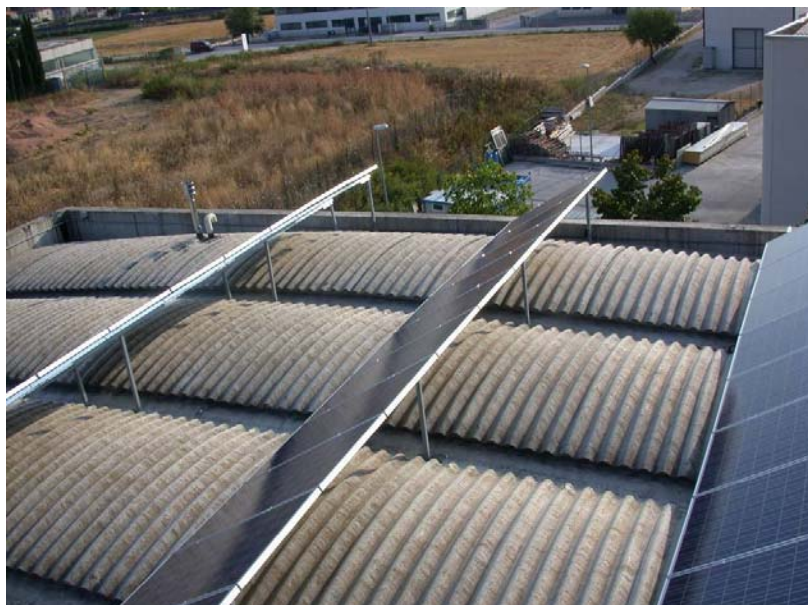
Figura 15 - Esempio di installazione non idonea alla classificazione dell'impianto fotovoltaico nella categoria "su edifici" – Motivazione: l'inclinazione dei moduli fotovoltaici rispetto al piano tangente supera i 10°.
